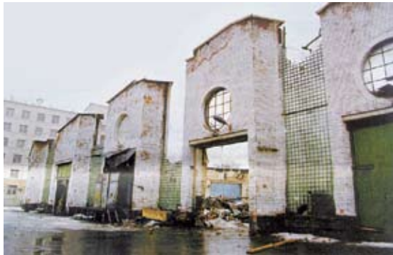
A buszgarázs félig tönkrement homlokzata (tervező: K. Melnyikov)
