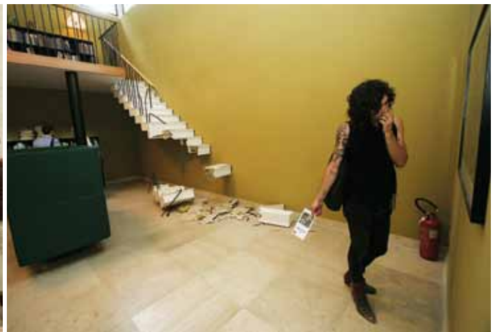
Leszakadt lépcső a dán pavilonban
